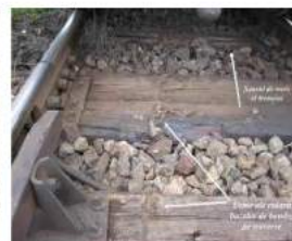
Foto nr.3 – Urme de rulare pe traverse
