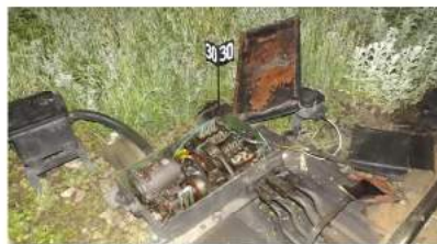
Fig.3 - Vedere de ansamblu a electromecanismului lovit
