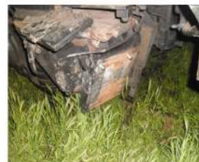
Fig. 5 - vedere cu cutia nisip deformată și placa de susținere a cutiei inductorului
